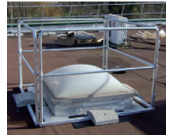
Photo 3 : protections permanentes de lanterneaux
